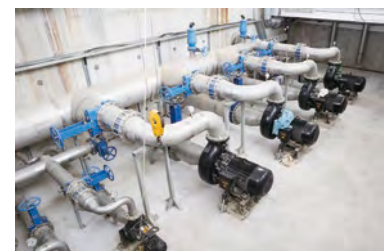
Установка очистки канализационных стоков
