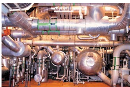
Optimális energiahatékonyság pl. komplex szivattyúalkalmazásokban
