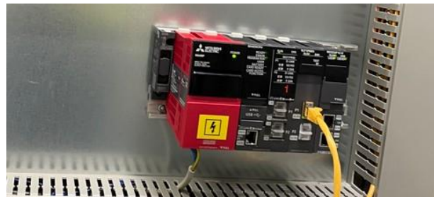
Die Melsec-Steuerung der I-QR-Serie liefert die Betriebsdaten für das Asset Portal über den Datenlogger RD55. Quelle: Mitsubishi Electric Europe B.V.
