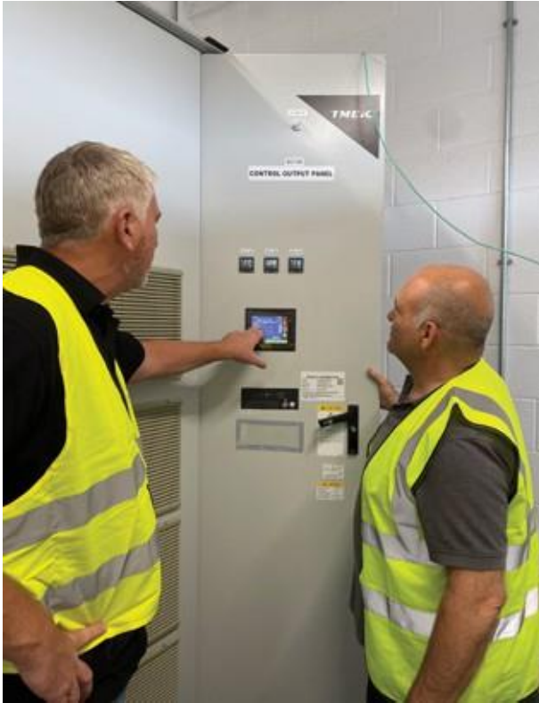
Die Visualisierung der Betriebsdaten erfolgt benutzerfreundlich über das GOT-Bedienterminal von Mitsubishi Electric. Quelle: Mitsubishi Electric Europe B.V.
