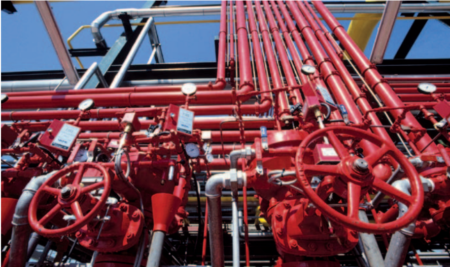
Sisteme de pompe din industrie - unul dintre domeniile convertizoarelor de frecvență FR-F700
