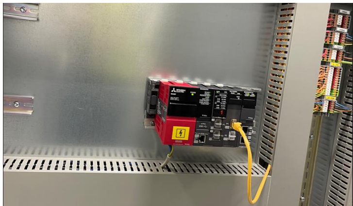
Immagine 7: Il controllore MELSEC della serie I-QR fornisce i dati operativi per l'Asset Portal tramite il data logger RD55.
