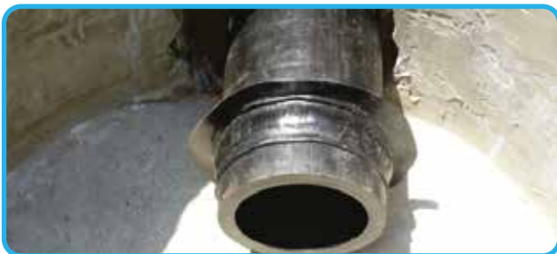
EMPALME A CÁMARA DE INSPECCIÓN (Buzón)
