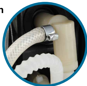
Zwischen Pumpe und Verteiler
