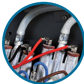
Zwischen Verteiler und Heizelement
