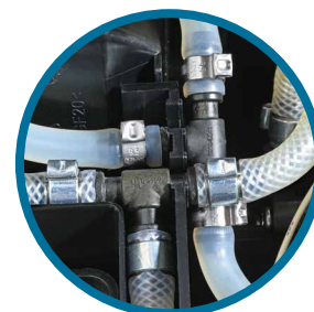
Entre l'élément chauffant et le brasseur
