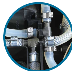
ヒーターとブリュー ワーの間
